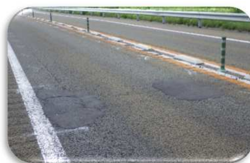
舗装損傷状況
