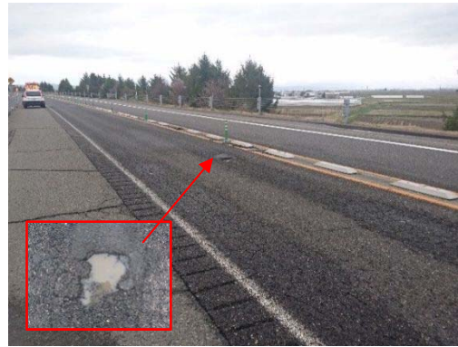
舗装路面の状況(会津坂下IC～会津若松IC間)
