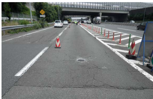
舗装損傷写真
