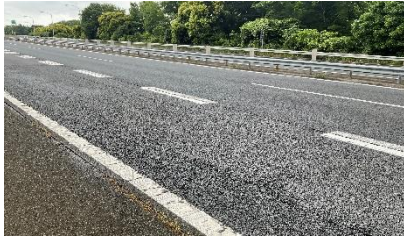
舗装損傷状況
