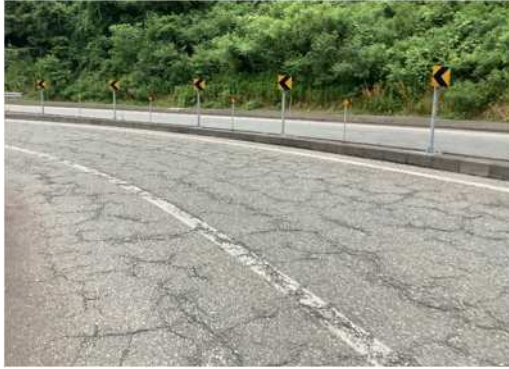
舗装損傷写真
