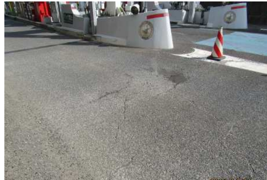
路面損傷状況
