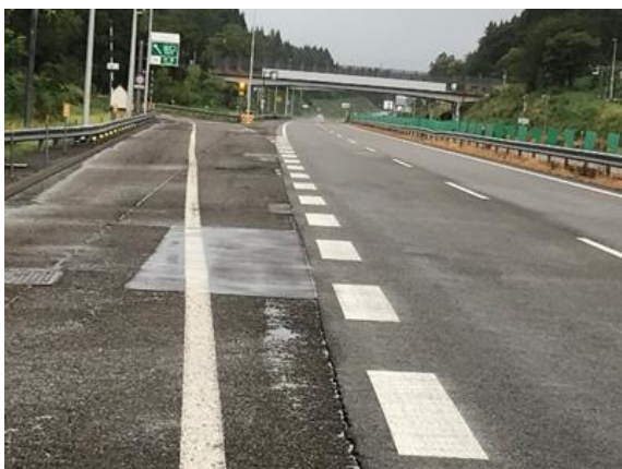
損傷した路面状況(中郷IC)
