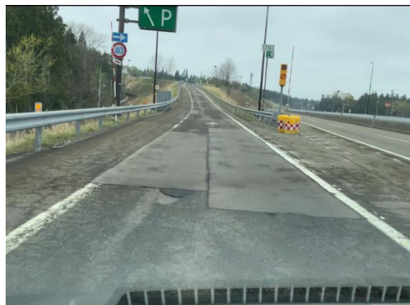
損傷した路面状況(妙高SA)
