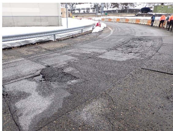
損傷した路面状況(土樽PA)
