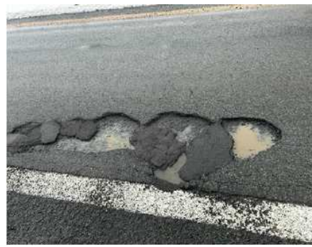
路面損傷状況(拡大)
