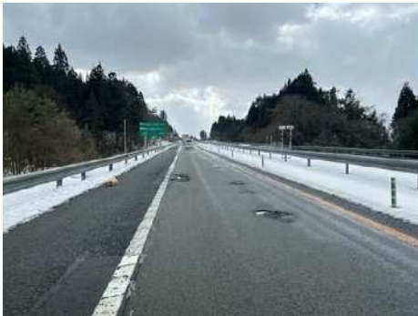
路面損傷状況
