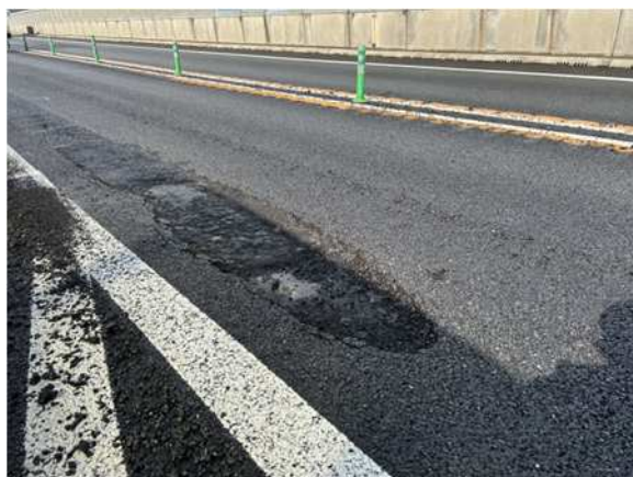
舗装損傷写真①
