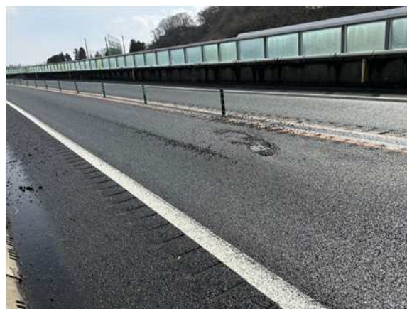
舗装損傷写真②
