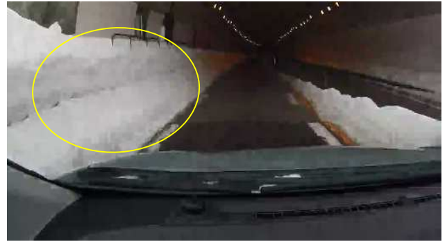
トンネル坑口付近堆雪状況
