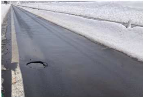
路面損傷状況
