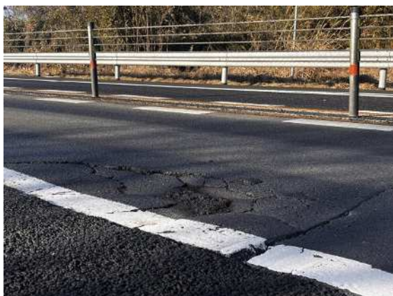
舗装損傷写真①
