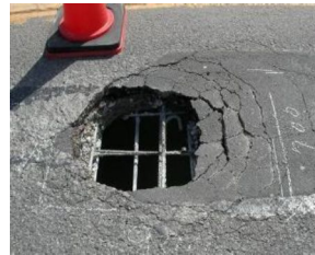
【道路が損傷した例】
