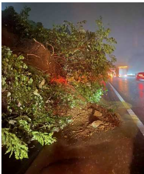
のり面からの土砂流出状況
