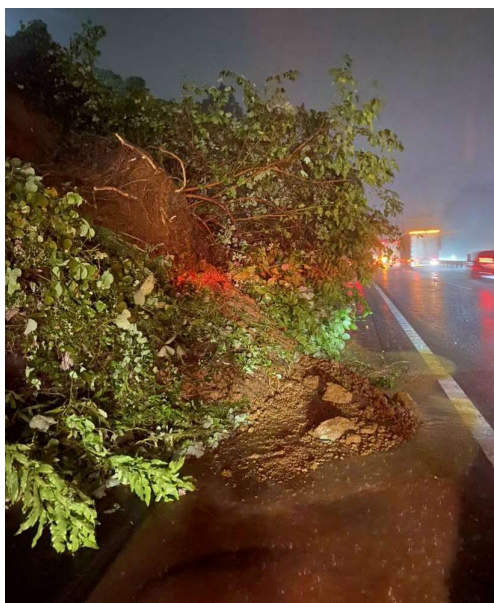
のり面からの土砂流出状況
