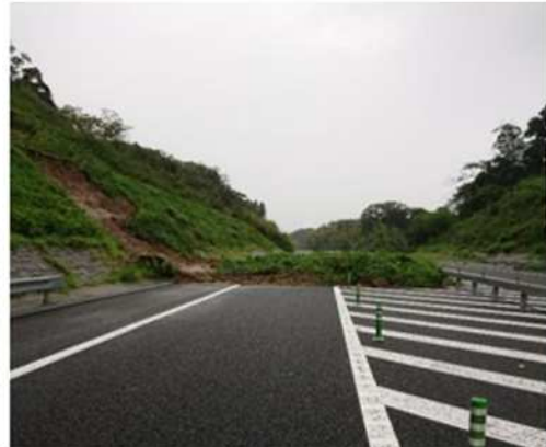
のり面の崩落
