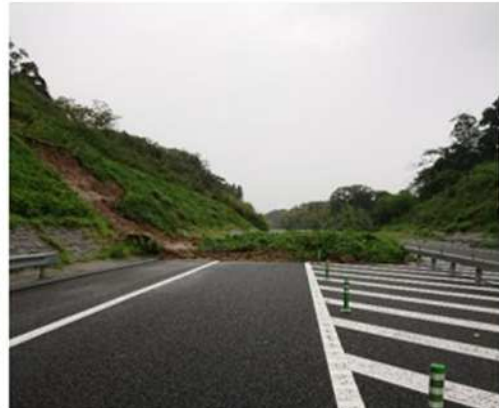
のり面の崩落
