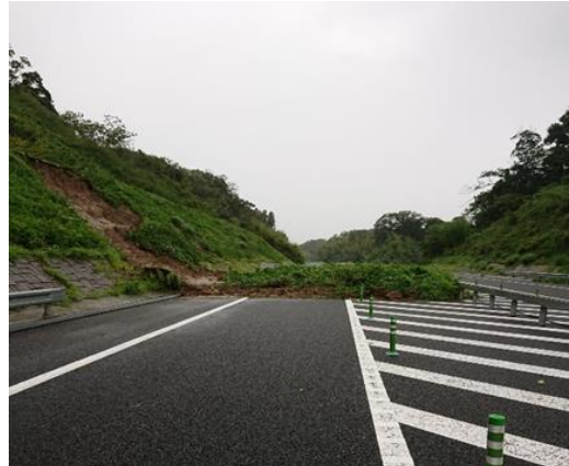
のり面の崩落
