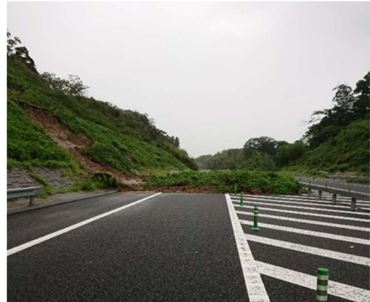
のり面の崩落
