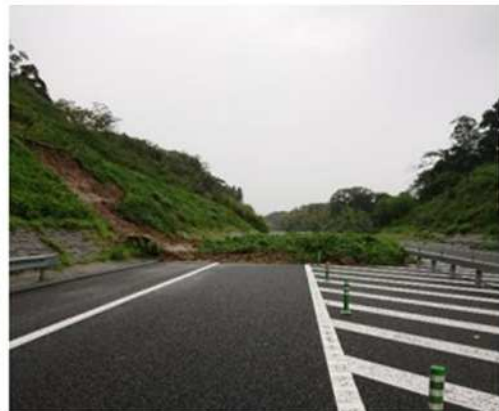
のり面の崩落
