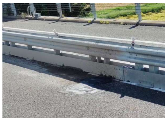
舗装の損傷(近景)
