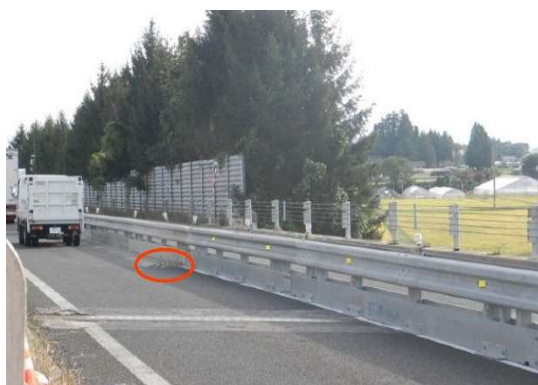
舗装の損傷(遠景)
