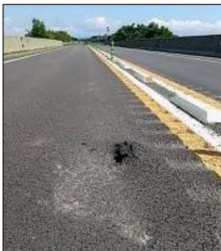
路面損傷状況
