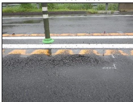
路面損傷状況
