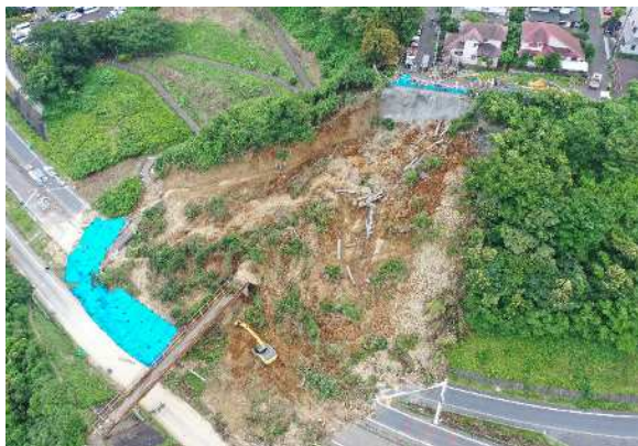
①のり面崩落状況(R3.7.14撮影)
