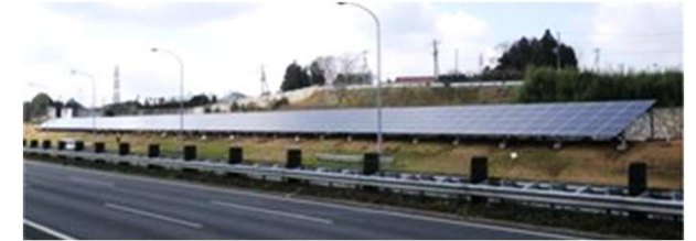
②太陽光発電による再生可能エネルギーの創造
