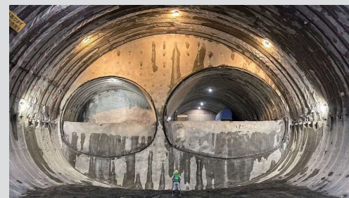
横浜環状南線 金利谷戸トンネル (最大断面積485㎡・幅29mの大断面トンネル)
