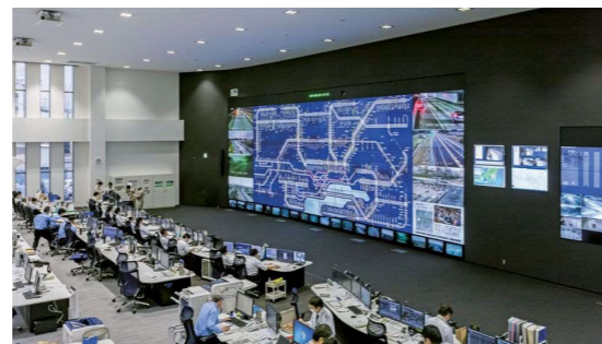
関東支社道路管制センター
