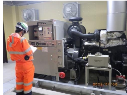
【自家発電設備の点検（施設）】
