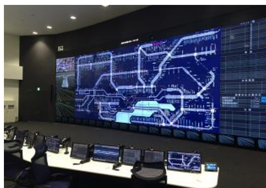
【道路管制センター（交通管制部門）】
