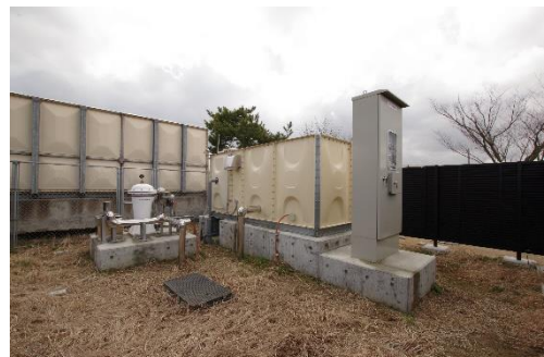
【断水時に備えた給水設備の整備状況】
