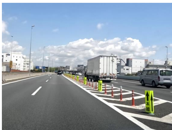
LED発光体付ラバーポールウイングサイン 【東関道 高谷 JCT】
