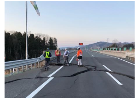
常磐道の被災状況
